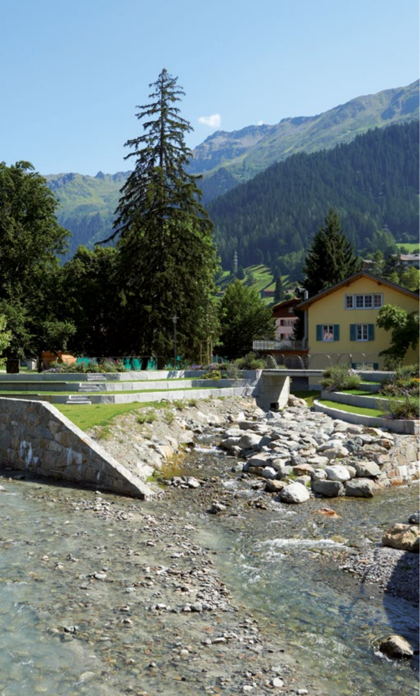
Hochwasserschutzprojekt Klosters, Folgeprojekt Hochwasser 2005. Im Innerortsbereich wurden neue Uferpromenaden erstellt und der Silvrettapark wurde neu gestaltet. Foto: Theodor Stalder.
