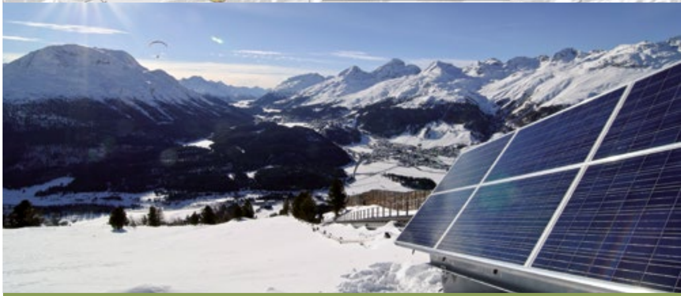
Solaranlage auf Muottas Muragl, Foto: ANU.
